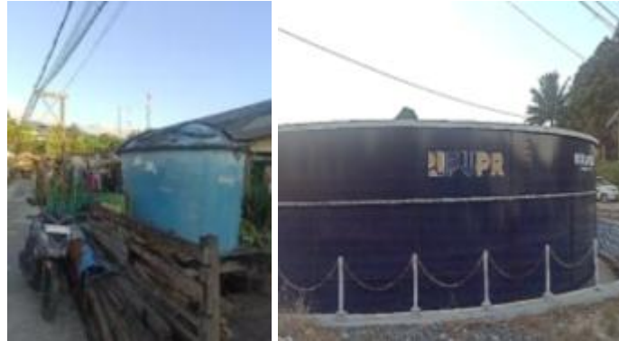
Gambar 4 Tangki Air Bersih di Desa Dirgahayu
